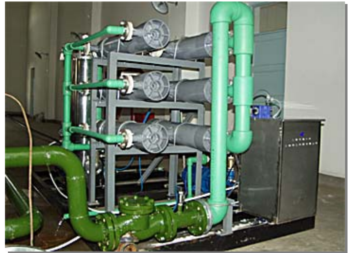
Shen Lan의 Membrane Contactor 보일러 탈산소 시스템
